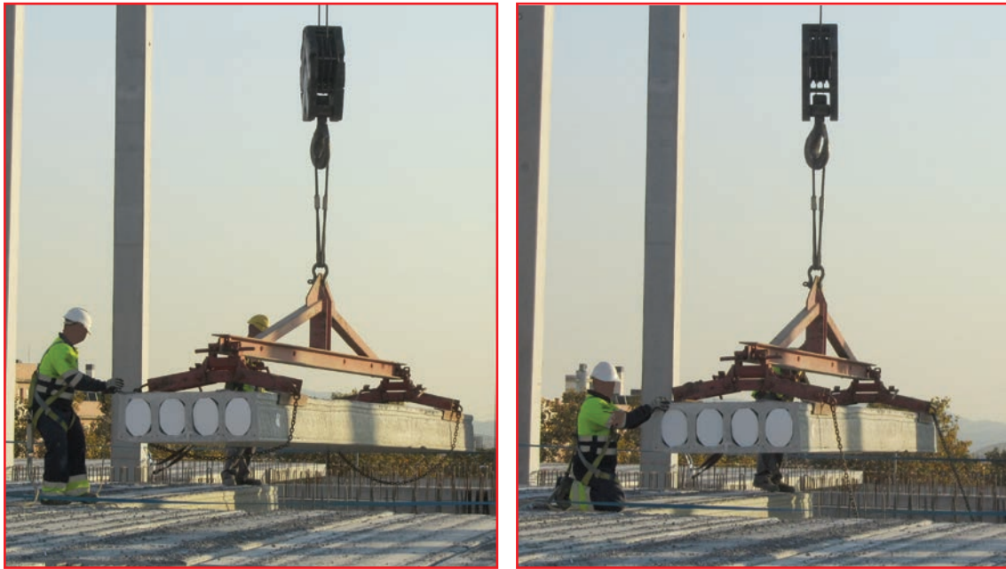
Figura 8 y 9.- Montaje de placa alveolar, se suelta la cadena de seguridad antes de colocar en su ubicación definitiva
