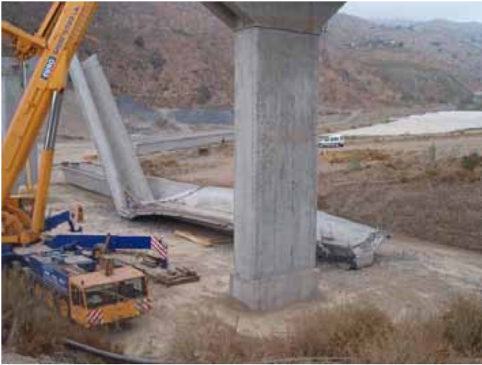
FIGURA 56 - SITUACIÓN FINAL DE LA VIGA DESPLOMADA
