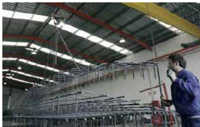
FIGURA 24 - TALLER DE ARMADURAS METÁLICAS (Fuente: www.grupo-mln.com )
