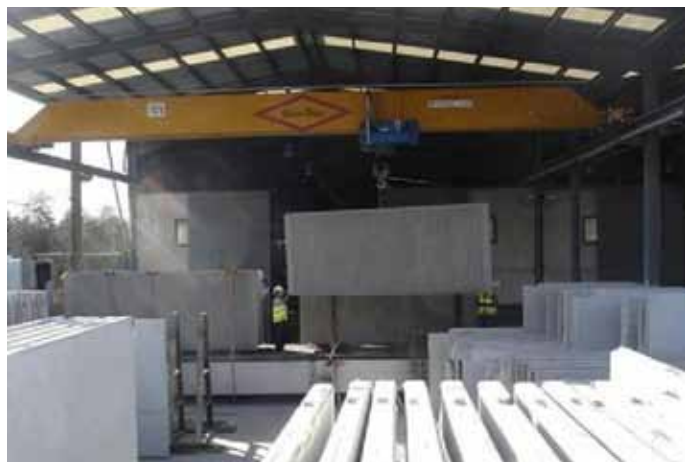
FIGURA 25 - PUENTE GRÚA EN LA ZONA DE ALMACENAMIENTO DE LA FÁBRICA
