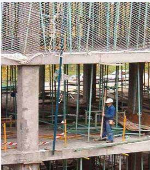
Riesgo de caída por falta de protección colectiva e individual
